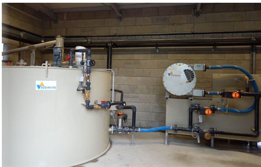
Groupe de préparation de lait de chaux et skid de pompe péristaltique à l'intérieur du bâtiment
