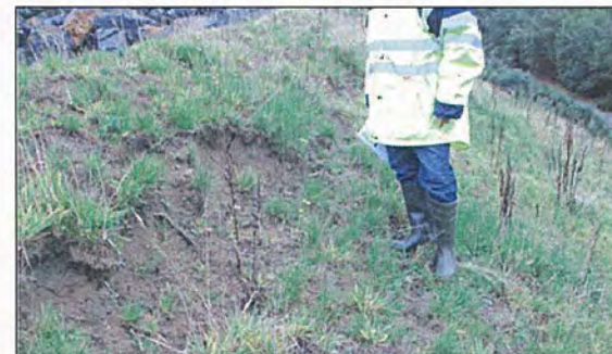
Photo 6 : Instabilité observée au niveau du talus Ouest
