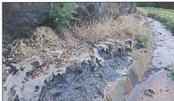
Photo 5 : Erosion de la couche de "PS" au pied de la verse
